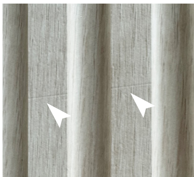
基材トップ層の擦り傷
